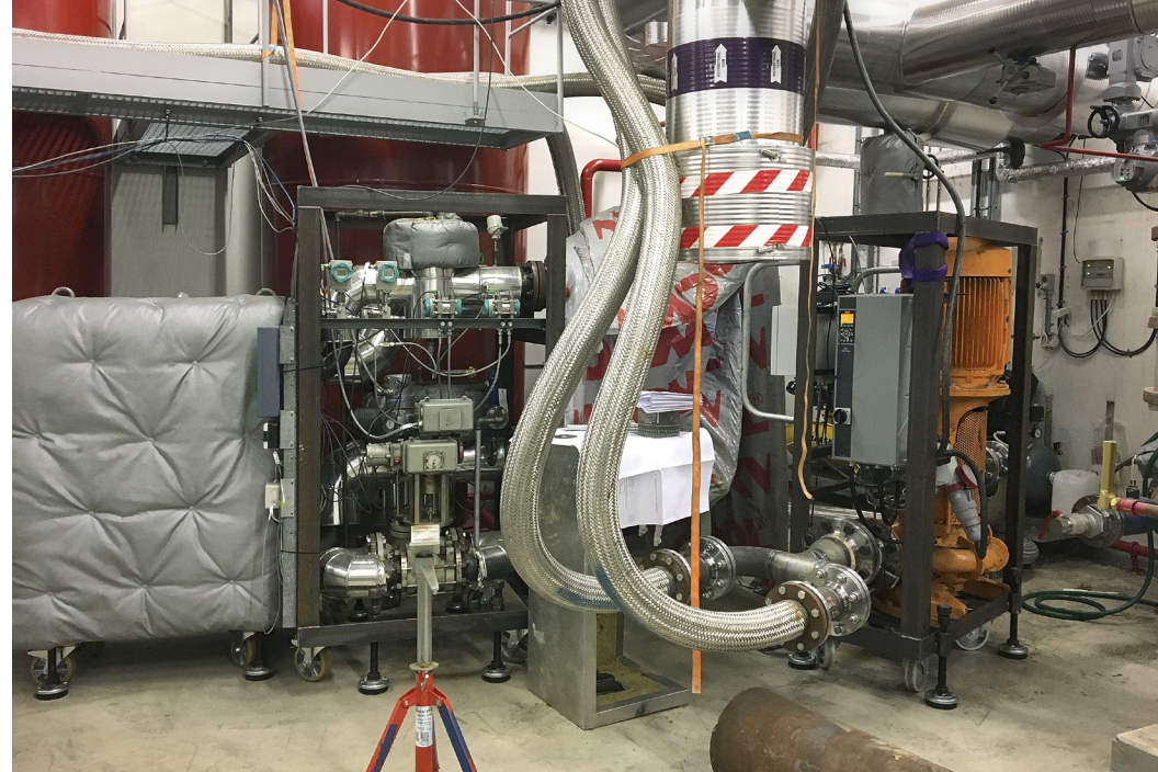
VEKS' "hjemmelavede" mobilveksler er også en del af beredskabet. Den fungerer som alternativ til den mobil-kedel, man sædvanligvis anvender, når et større og længerevarende vedligeholdelsesarbejde står for døren. Flere af de lokale fjernvarmeselskaber i VEKS' forsyningsområde har lånt kedlen i forbindelse med planlagte reparationer.
